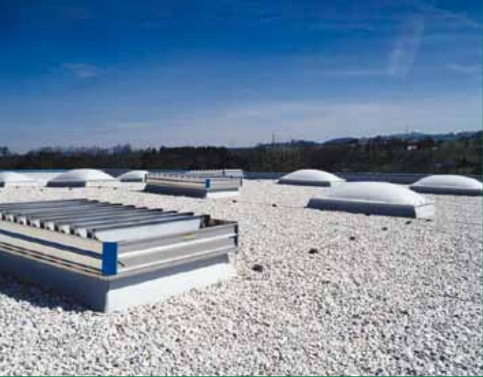
Dachsystem mit AUSTROPLAN FPO Dachbahn und Kiesauflast.
